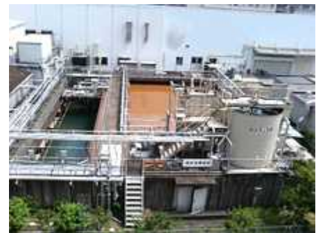
排水処理設備（鶴見工場）
