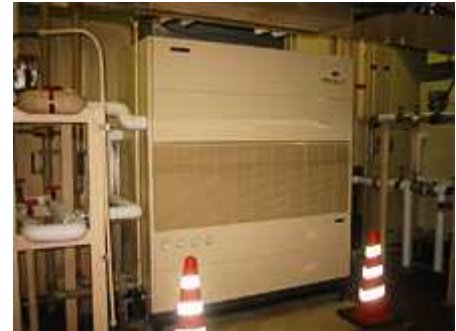
代替冷媒使用空調機（小山工場）
